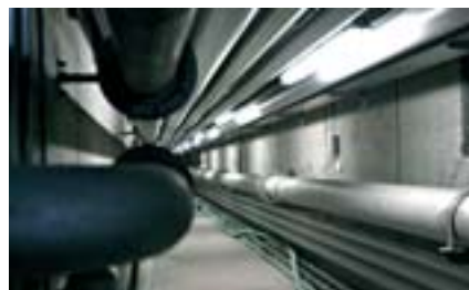
Leitungsschacht für Fernwärme
