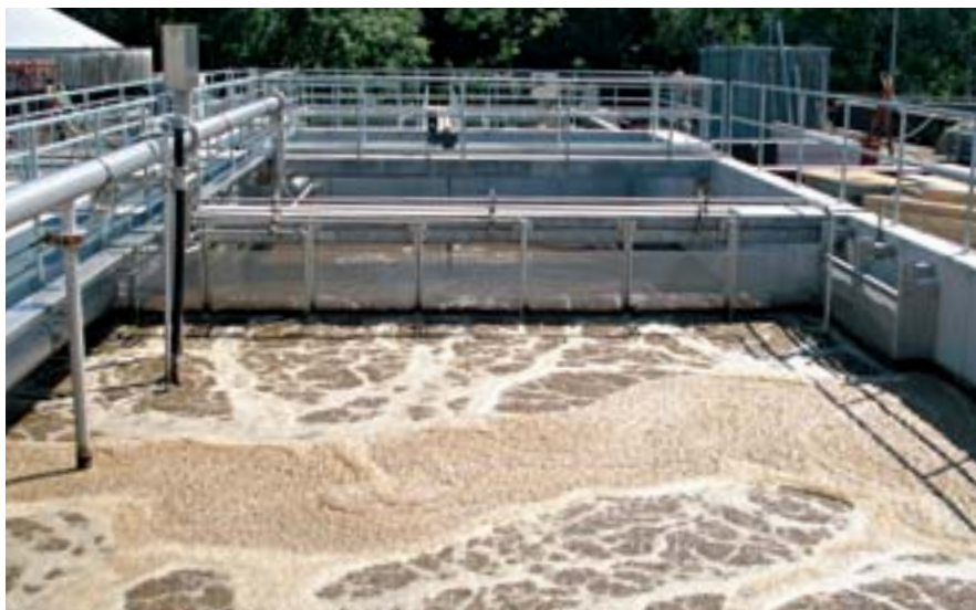
Statt mit aufwändigem Beckenausbau wird mit einem Wirbelbett die biologische Reinigung in der ARA Bazenheid optimiert.
