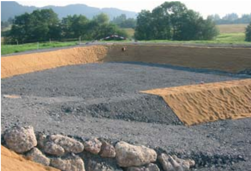
Strassenabwässer werden in die ausgehobenen, natürlichen Becken geführt.
